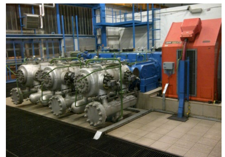
Kompressor mit HydroCOM und Überwachungssystem
