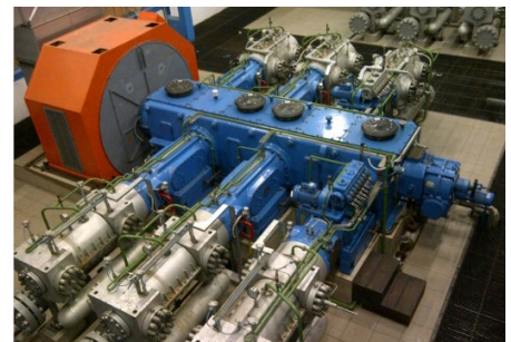
Kompressor mit HydroCOM und Überwachungssystem
