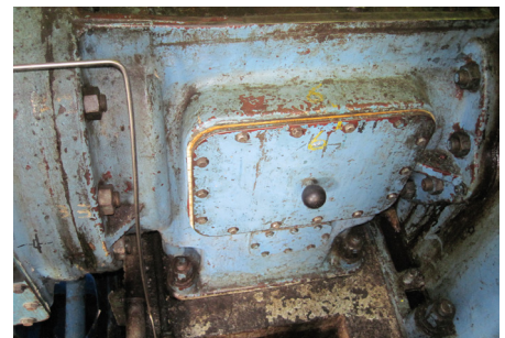
Alte und gerissene Kreuzkopfführung
