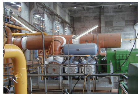
Einer der beiden Propylenkompressoren
