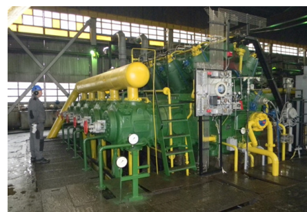
Überarbeitete integrierte Kompressoranlage, bestehend aus 5 Kompressorzylindern und 10 Antriebszylindern
