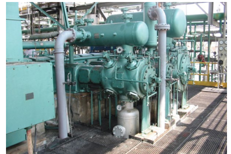
Booster- und Primärkompressoren
