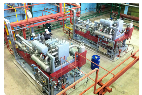
Beide Kompressoren arbeiten vor Ort
