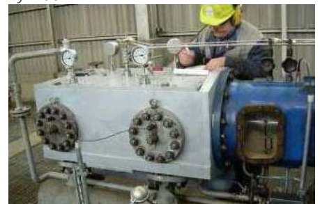
Einer der vier neuen Zylinder im verbauten und geprüften Zustand
