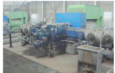
Kompressor mit alter Zylinderausführung
