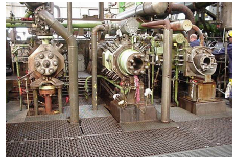
Kompressoranlage des Ammoniakwerks
