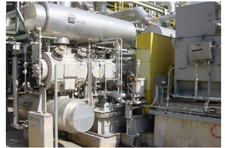
Einer der drei Wasserstoffkompressoren
